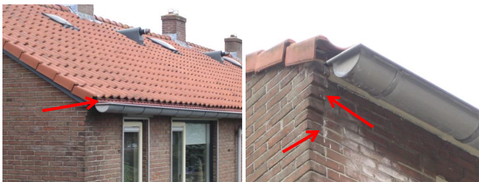
Afbeelding 7: vogelschroot onder de dakrand (links), de mestsporen op de gevel net onder de dakrand wijzen op een mogelijke nestlocatie van de huismus (rechts) (SAB, 2013).
