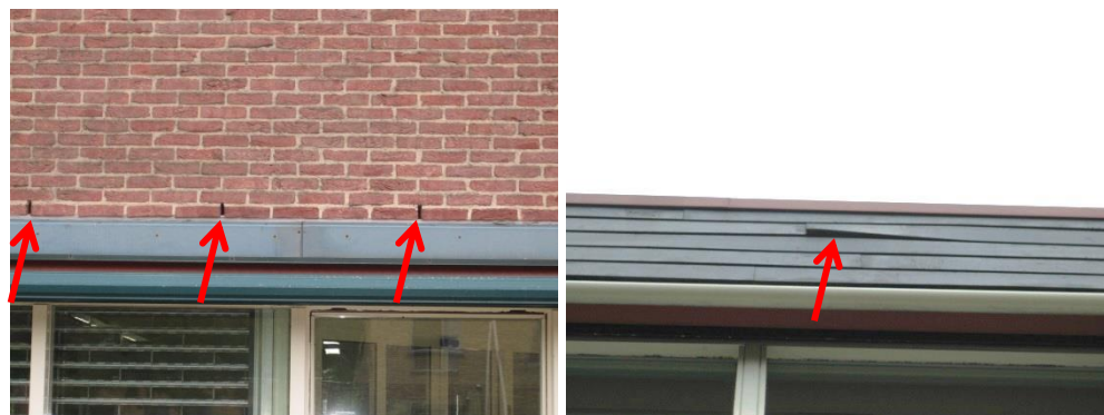
Afbeelding 11: open stootvoegen (links) en kierende gevelbetimmering (rechts) in deelgebied 7; ABN Amro-locatie (SAB, 2013).
