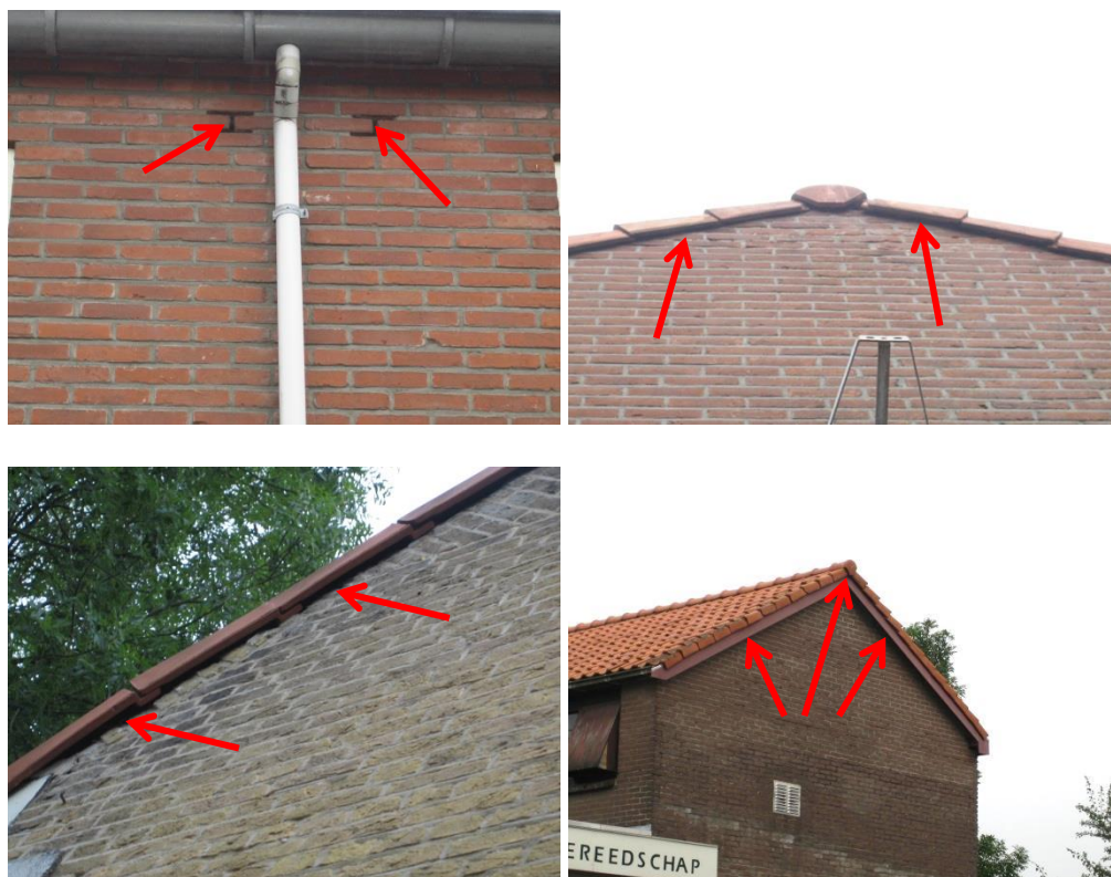
Afbeelding 5: v.l.n.r.: toegang tot de spouw via open stootvoegen; toegang tot het dakbeschoot via overstekende dakpannen (foto 2 en 3); toegang tot het dak via gevelbetimmering en dakpannen (SAB, 2013).
