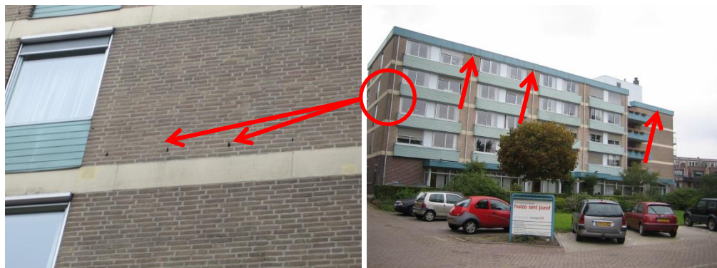
Afbeelding 9: mogelijke toegangspunten tot vleermuis verblijven. Links: via open stootvoegen. Rechts: via de gevelbetimmering (SAB, 2013).
