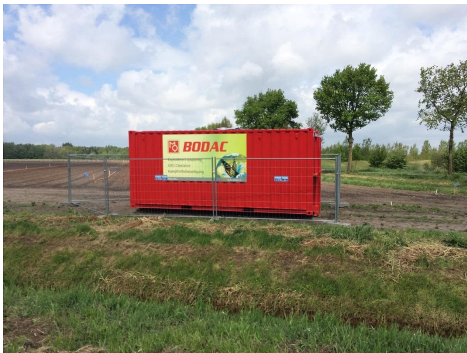
Figuur 7: 20 ft. container waarin de VTVS is geplaatst gesitueerd in het veld.
