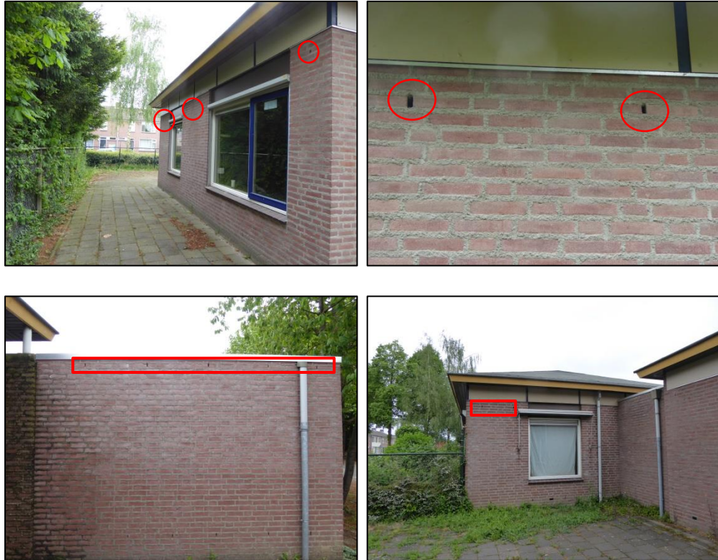
Open stootvoegen (rood omkaderd) in het voormalige schoolgebouw in het plangebied.
