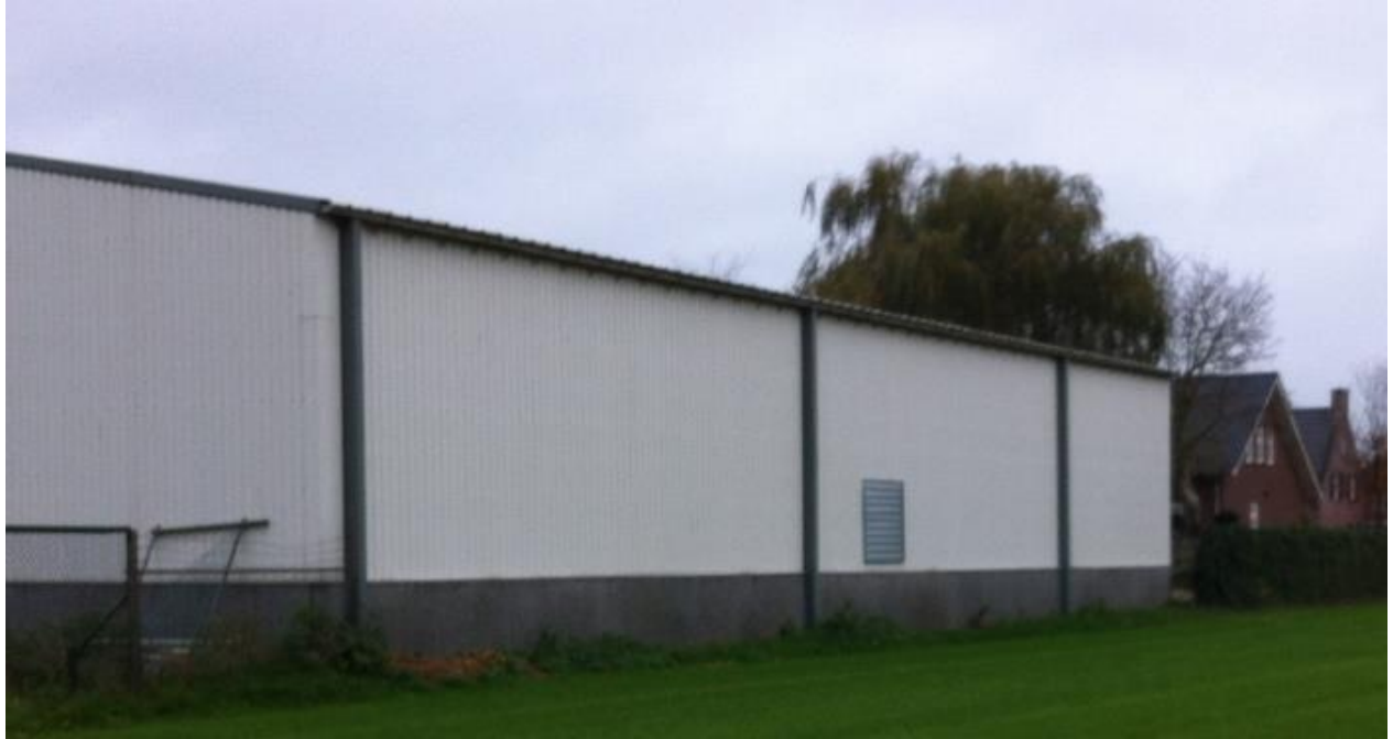
Afbeelding 2. Ventilator in de noordwestgevel van Uilencotenweg 8a
