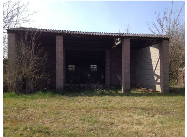
Foto 2: schuur met asbestverdacht dak (golfplaat)
