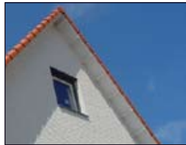
gekeimde gevel is alternatief voor baksteen in warme kleur; aandacht voor details zoals
