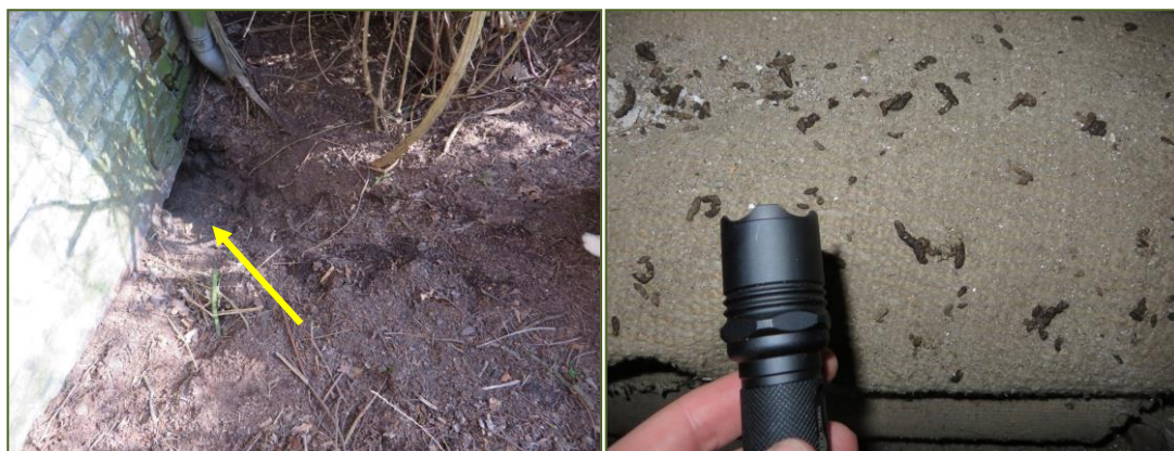
Foto's: Opening naar ruimte onder fundering en vleermuiskeutels.
