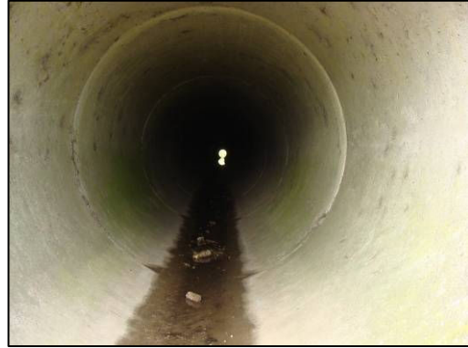
Foto 10. belopen dassentunnel onder N271
