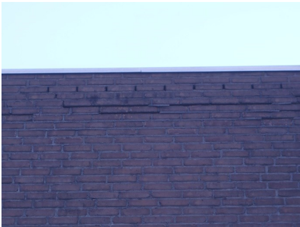
Foto 2: de westgevel van de gymzaal met de vele open stootvoegen
