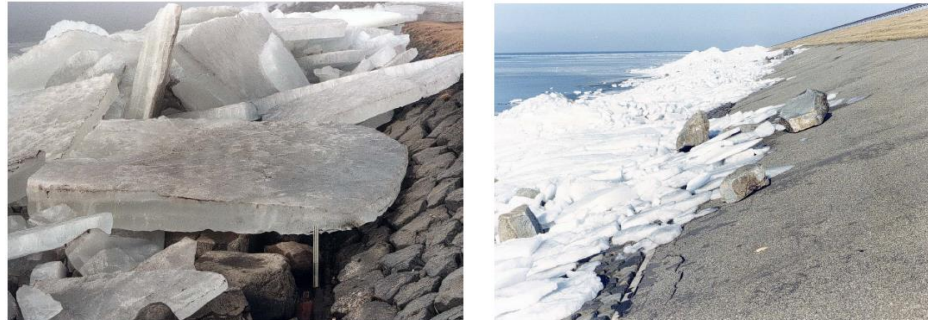
Figuur 23 Links een foto van flinke ijsschotsen tot de berm van een dijk. Rechts kruiend ijs op de houtribdijk. Merk op dat de steenbekleding los is gekomen door het ijs.
