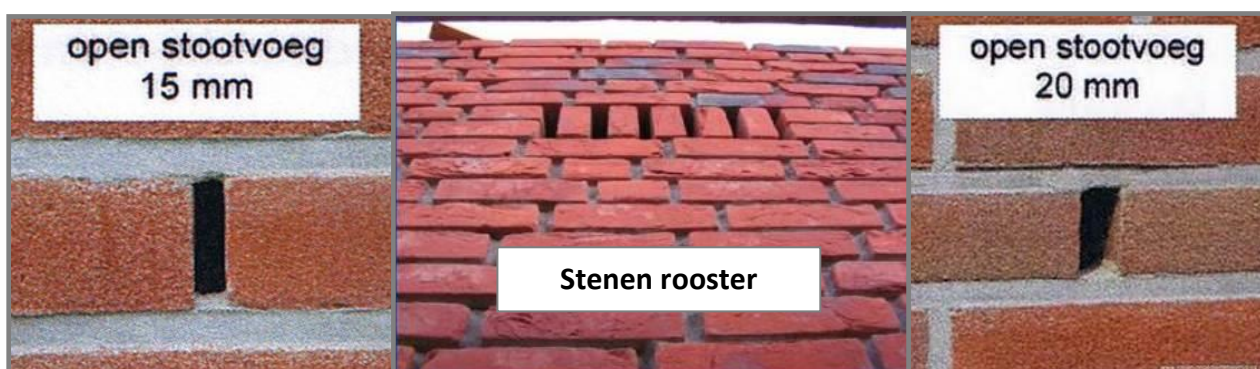
Figuur 2 | Open stootvoegen en een stenen rooster.
