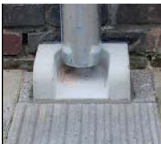
Figuur 7: regenpijp eindigend boven de grond
