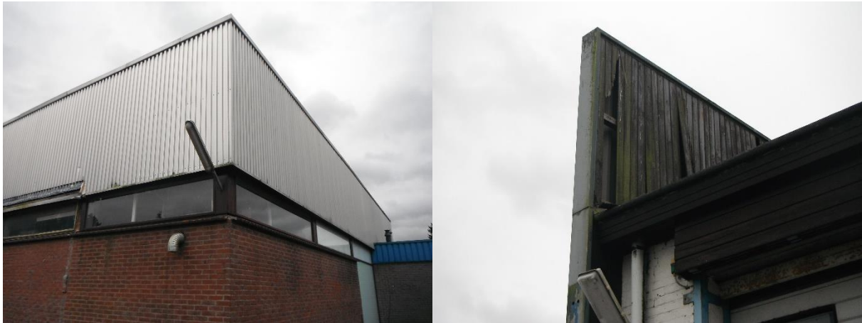
Figuur 3-1. De bebouwing is ongeschikt als verblijfplaats. Links aluminium gevelbekleding, rechts een muur die aan de achterzijde met hout is afgewerkt, maar in slechte staat is.
