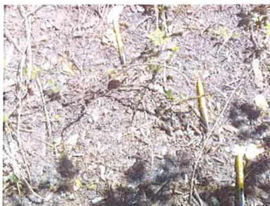
Asbest verdacht materiaal op maaiveld (2)
