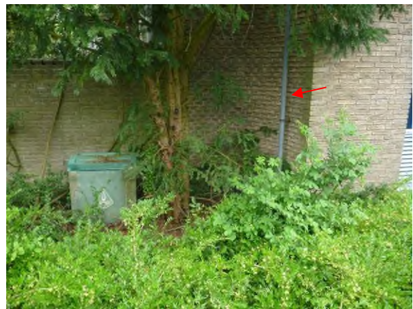
Tankontluchting bij ketelhuis
