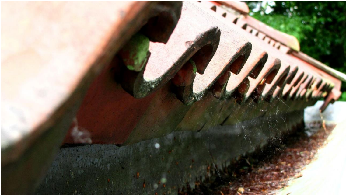
Figuur 13. De dakpannen van het hoofgebouw en van het ketelhuis geven geen ruimte voor huismussen om onder het pannendak te komen.
