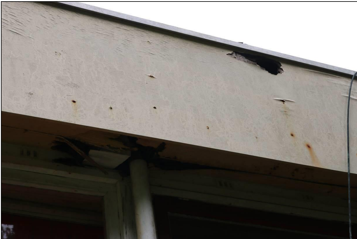
Figuur F. Gaten in betimmering (vml. verblijfslocatie) geven vleermuizen mogelijk toegang tot het gebouw.
