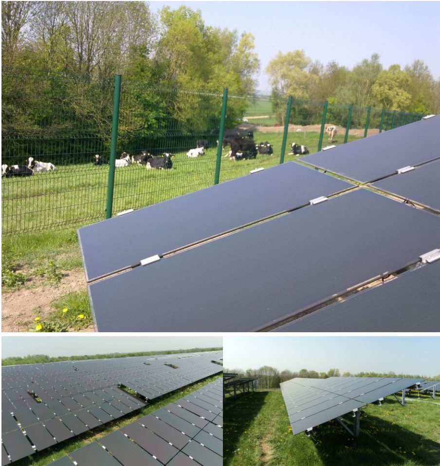
Indicatieve weergave zonnepanelen op een solarpark
