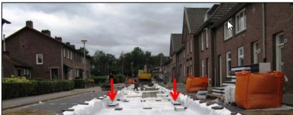
Afbeelding 4 – aanleg WT kolken met bezinkunit voor straatwater en permavoid huisaansluitingen voor daken
