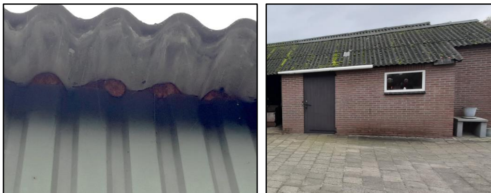
Figuur 4 De toegang tot het dak van schuur G is geblokkeerd door de aanwezigheid van purschuim (links). Het dak van het deel van schuur F dat dakbeschot heeft is niet goed toegankelijk voor huismussen voor de afwezigheid van een dakgoot en (deels) de aanwezigheid van een plastic koker om de dakrand.
