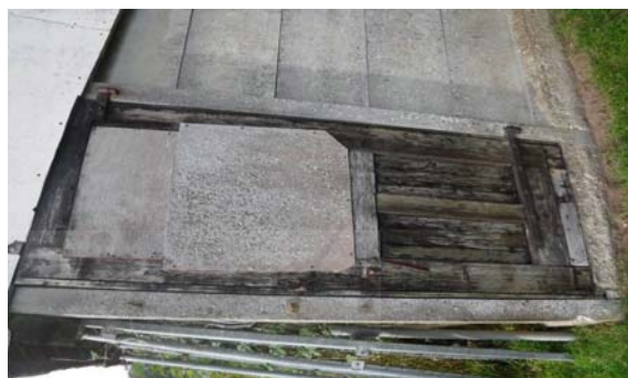
Plaat op de deur asbestvrij
