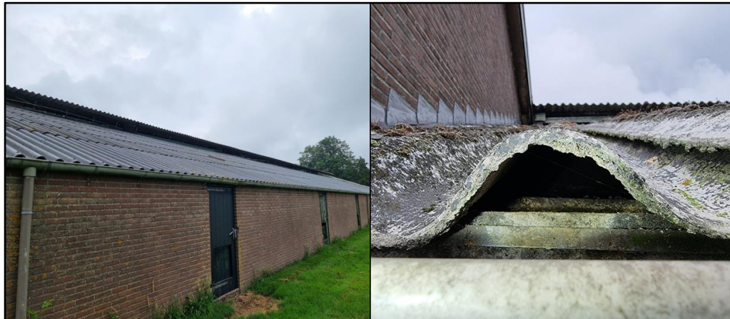
Figuur 5 Het dak van de varkensstal met zichtbaar ruimte onder de golfplaten. Echter zijn er geen nesten waargenomen onder het dak tijdens inspectie met zaklamp.
