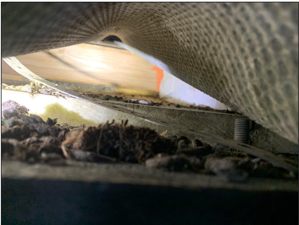
Figuur 4 Onder het golfplaten dak zijn grote hoeveelheden uitwerpselen van ratten aangetroffen.
