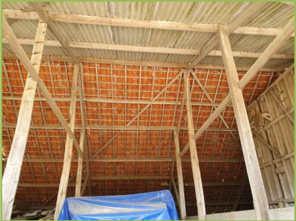
Missend dakbeschot bij kapschuur
