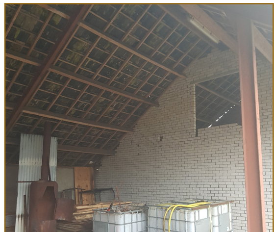
Afb. 2.4: Dak en tussenmuur van de kapschuur. Er werden geen nesten of (potentiële) vleermuisverblijfplaatsen aangetroffen.
