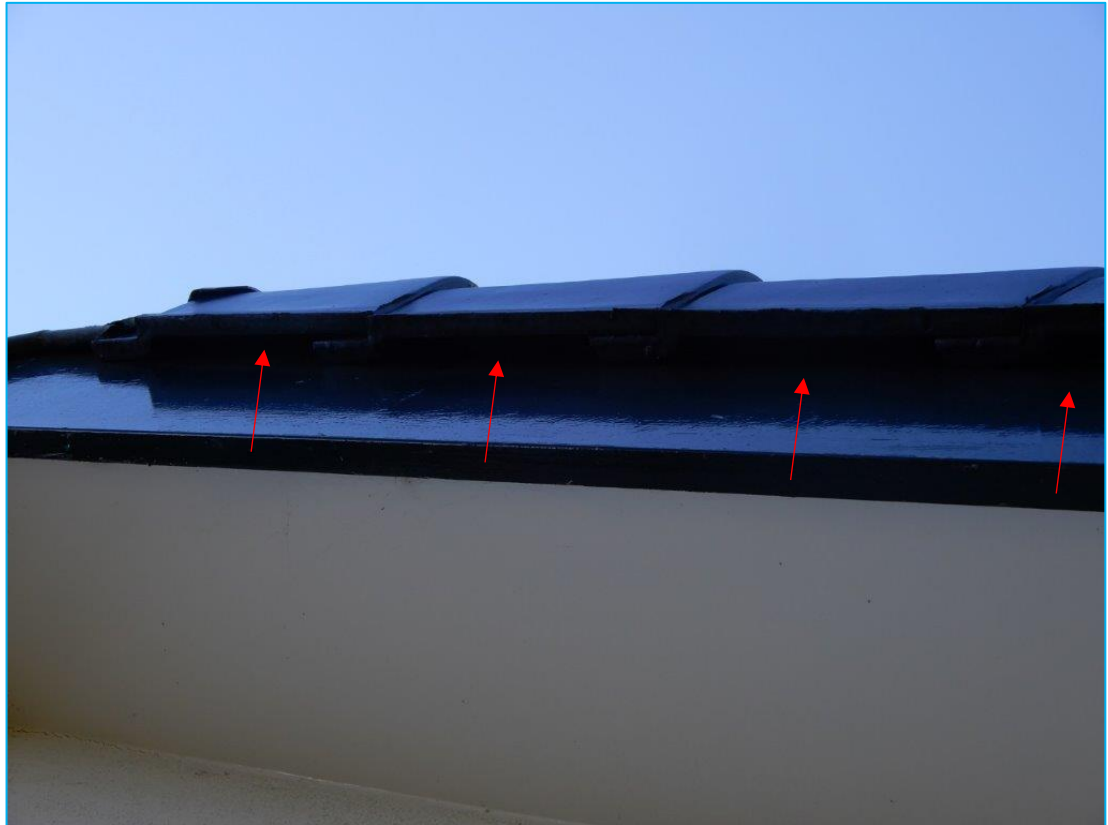
Foto: Openingen bij gevelpannen die toegang bieden tot ruimte tussen dakpannen en beschoot.
