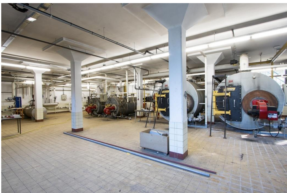
Het ketelhuis verkeert goeddeels in oorspronkelijke staat. Veel van het installatiemateriaal is nog aanwezig en tegelafwerkingen stammen uit de bouwtijd.
