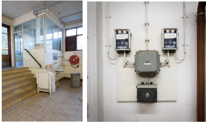
Controleruimte in het ketelhuis en schakelmateriaal op de wand
