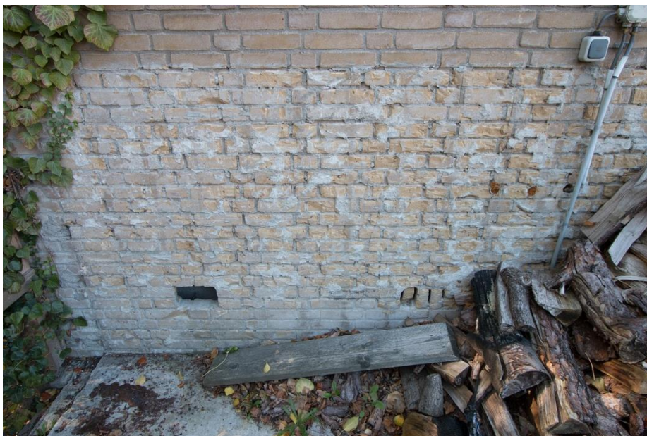
Beschadigd metselwerk ontstaan als gevolg van sloop van een buitenberging.
