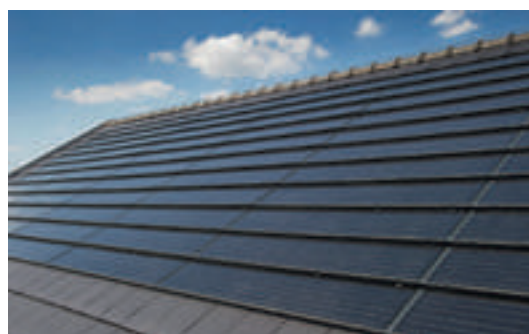
Fraai geïntegreerde zonnepanelen
