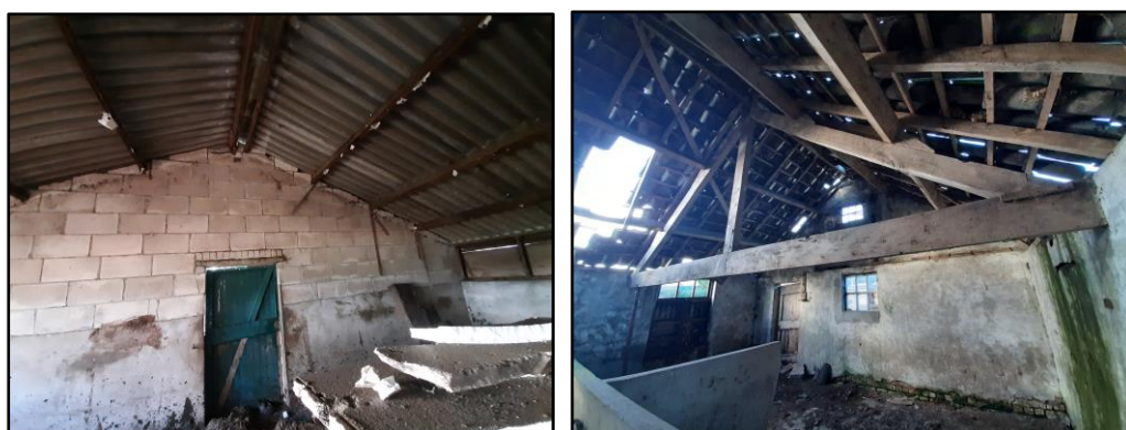
Figuur 3 Voorbeelden van gebouwen waar dakbeschot ontbreekt.
