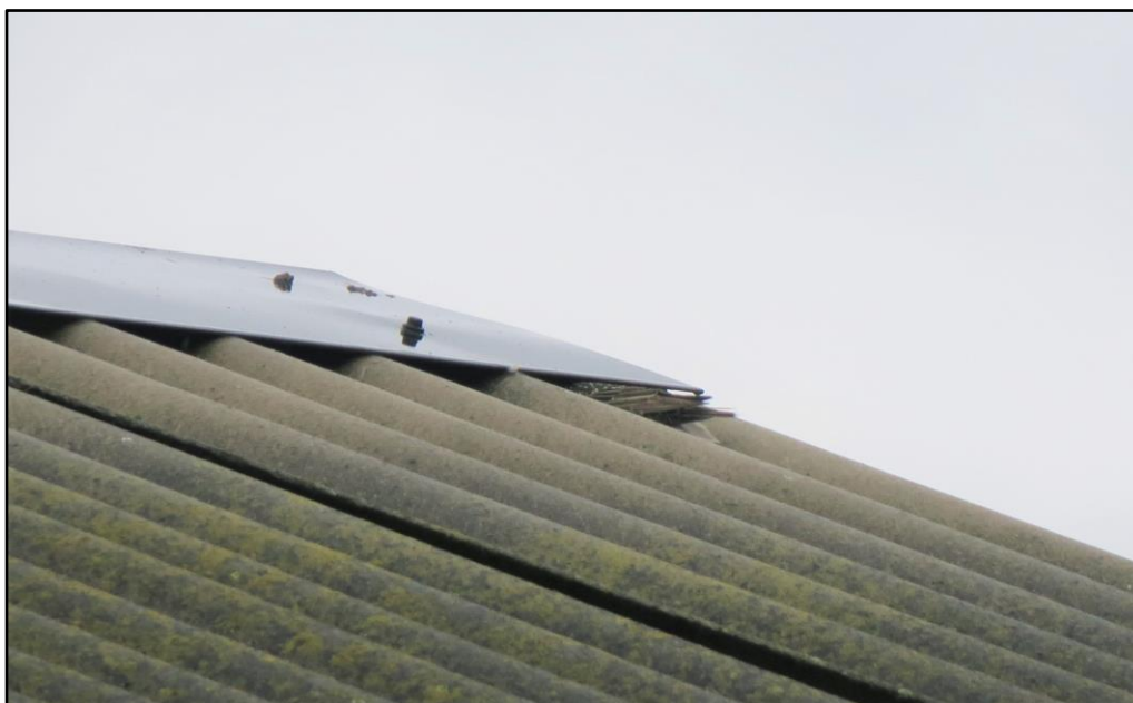
Figuur 4 Het spreeuwnest bevindt zich direct onder het dak.
