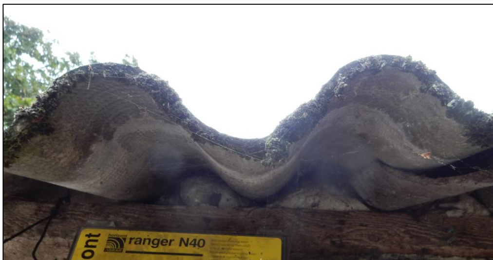
Figuur 6 Visuele representatie van het dak van schuur B. De ruimte tussen de golfplaten en het dakbeschot is gedicht.
