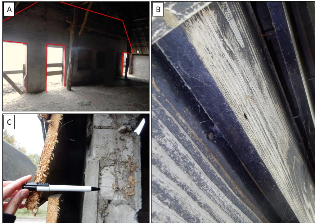
Figuur 4 De westzijde van de schaapskooi. (A) aan alle rood gearceerde zijden ligt de ruimte tussen de potdeksels en de betonnen muur open. (B) de potdeksels kieren op meerdere plekken waardoor de ruimte tussen de potdeksels en betonnen muur toegankelijk is. (C) de ruimte tussen de betonnen muur en potdeksels is erg groot (zie vergelijk met pen).
