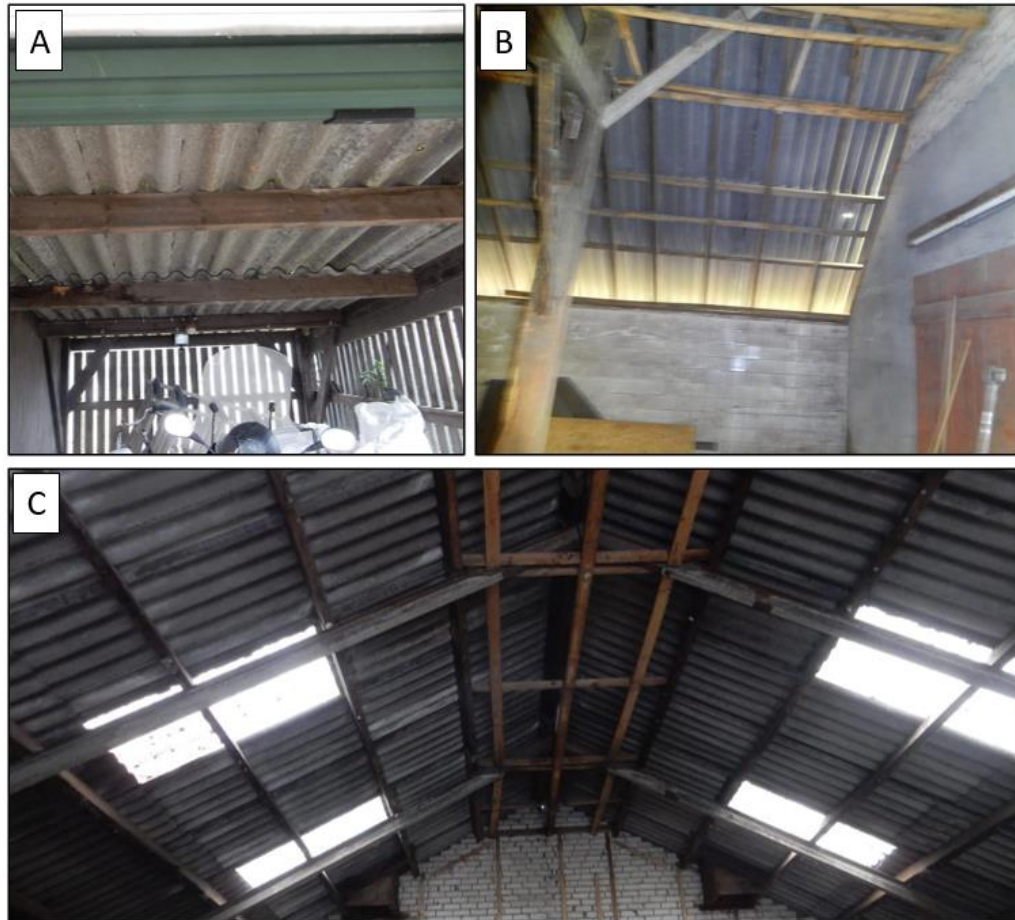
Figuur 3 De te saneren bebouwing bevat golfplaten daken zonder dakbeschoot. (A) de schuur. (B) de schaapskooi. (C) de paardenstal.
