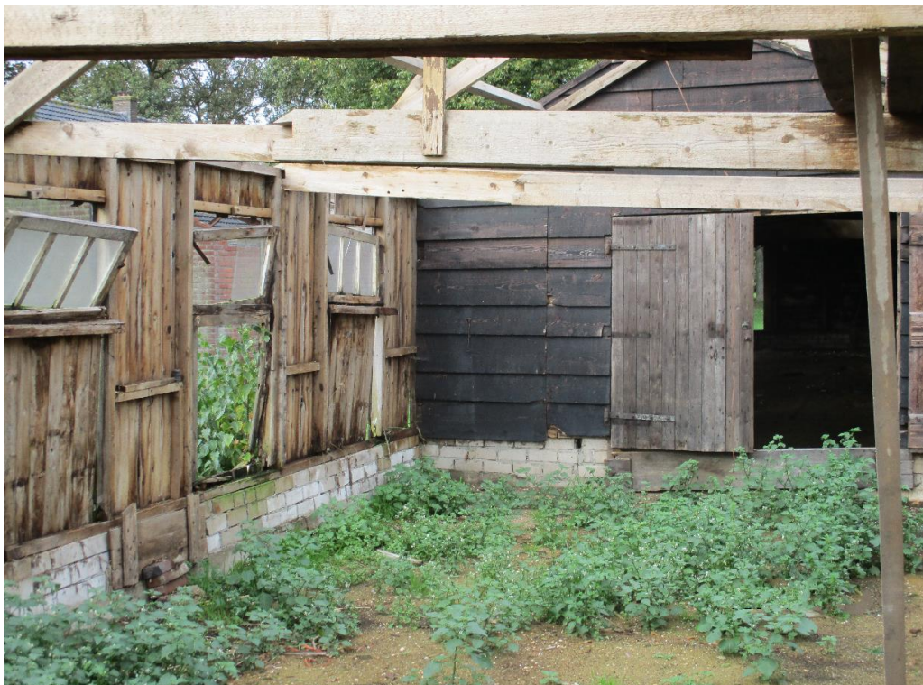
Figuur 2 Een van de vervallen stallen.
