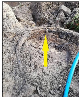
Afb.7 – Geraakte kabel in het opsporingsgebied
