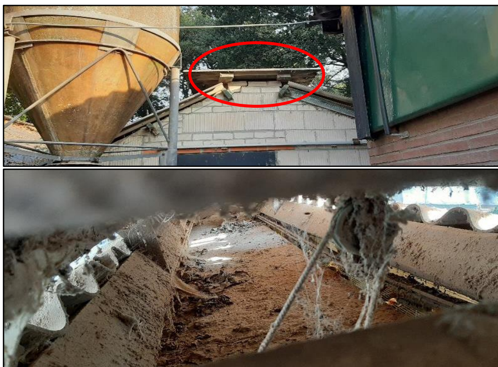
Figuur 5 Ventilatie goot in nok van kippenschuur (gebouw D3). Er zijn foeragerende huismussen in aangetroffen, maar er is geen nestmateriaal gevonden.
