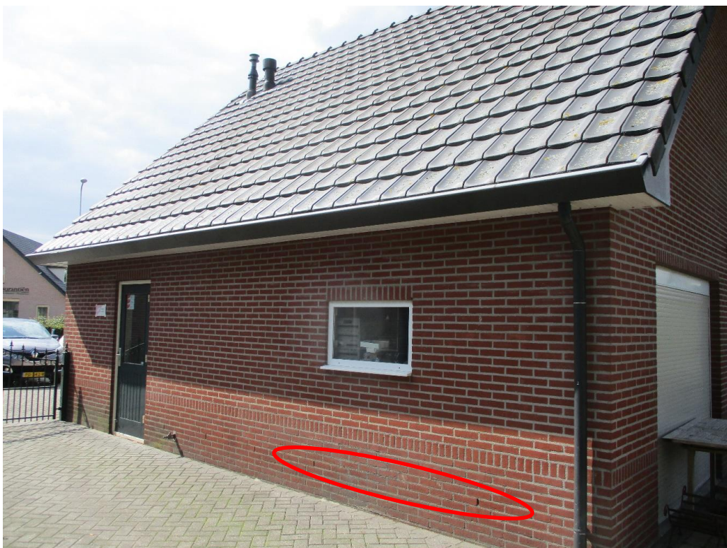
Figuur 2 De aanwezige stootvoegen bevinden zich op beperkte hoogte boven de grond, waardoor deze niet toegankelijk zijn voor vleermuizen.
