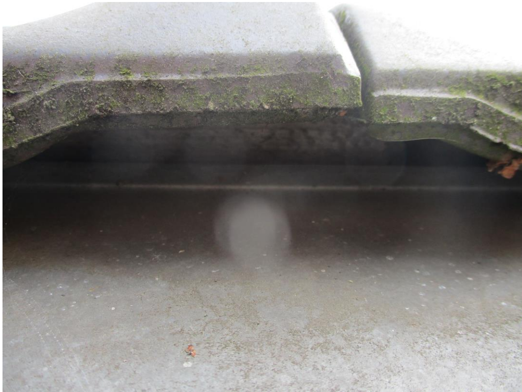
Figuur 3 Onder de dakpannen is een balk, die de doorgang voor huismussen versperd. Derhalve zijn nestlocaties van de huismus uitgesloten.
