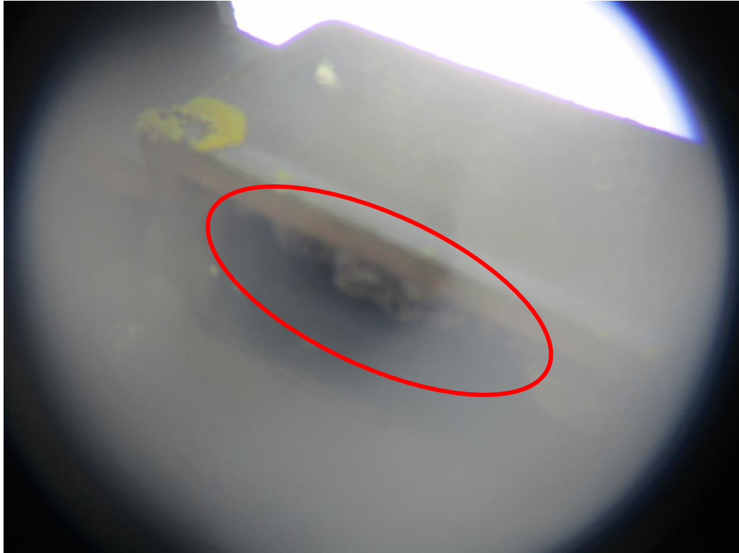
Figuur 1 Onder de kantpannen is porschuim aangebracht (rood omcirkelt), waardoor deze ontoegankelijk zijn voor vleermuizen.
