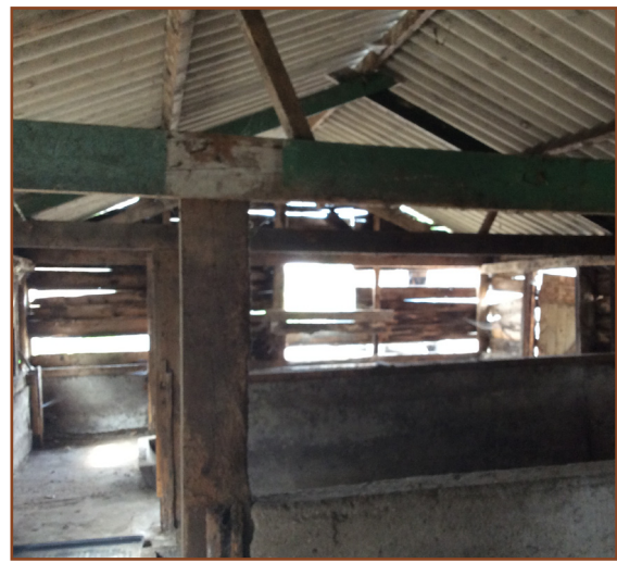
Afb. 2.2: Binnenzijde noordoostelijke stal. Op de foto is duidelijk te zien hoeveel lichtinval er is door de kieren en gaten in het hout.
