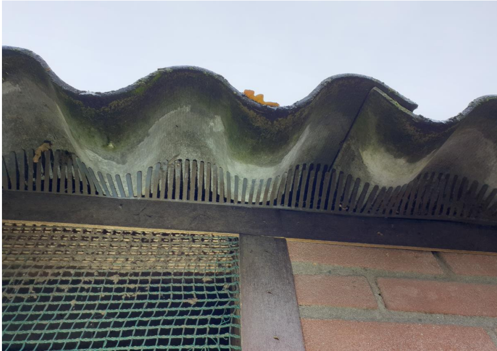
Figuur 6 Vogelschroot aanwezig onder het dak van de varkensschuur.
