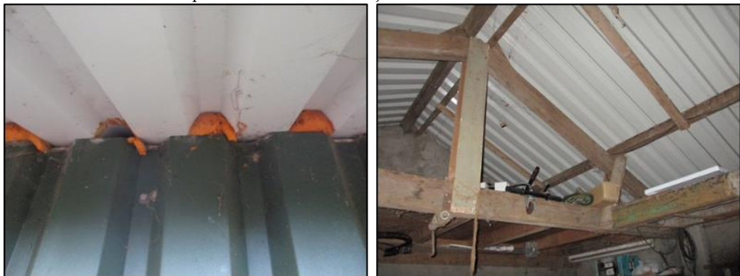
Figuur 4 De openingen in het dak van de loods met de isolatieplaten tegen de binnenkant van het dak aan, zijn gedicht met purschuim (op slechts enkele na). In de andere loodsën ontbreken isolatieplaten, waardoor deze minder geschikt worden.
