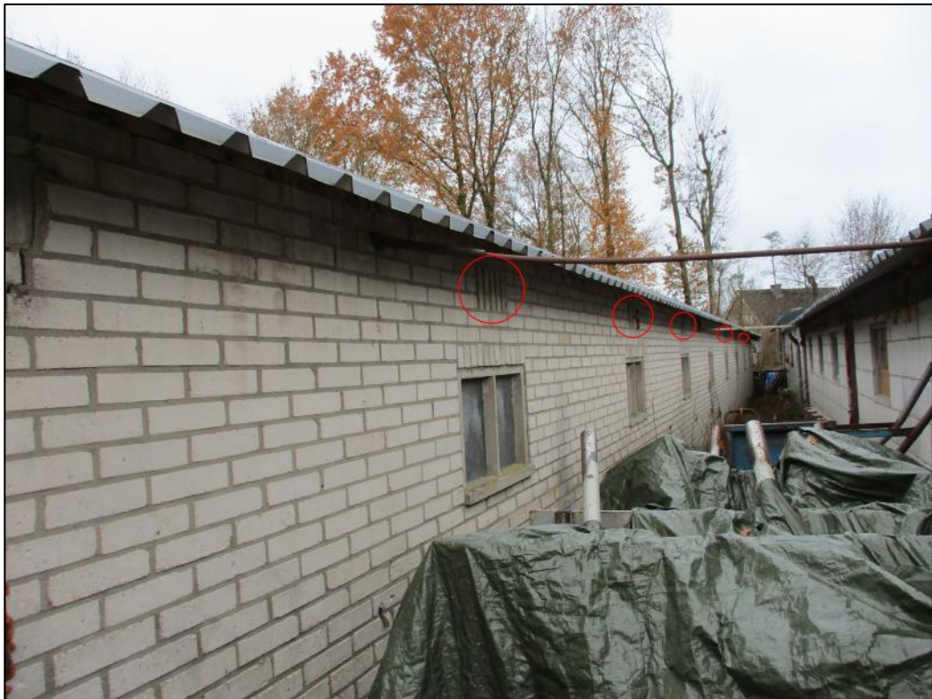
Figuur 2 In een van de te saneren loodsen zijn een aantal open stootvoegen waargenomen.
