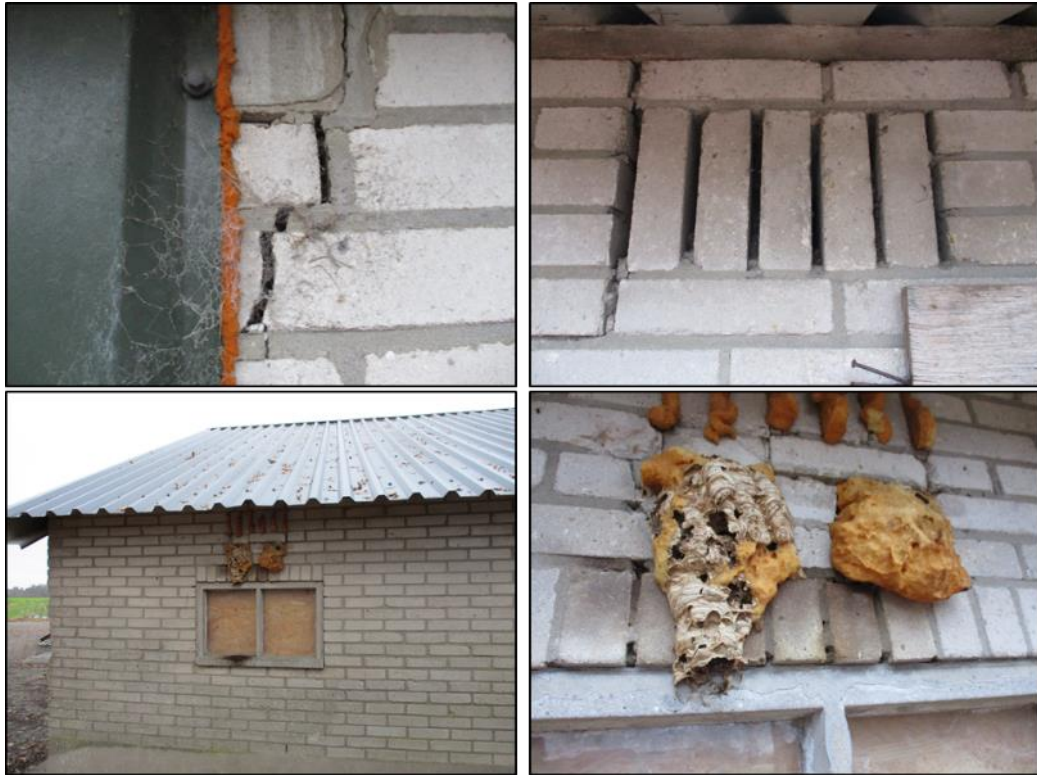
Figuur 3 Een aantal van de stootvoegen zijn afgedicht met pur (waar zich tevens een oud wespenest bevindt) en vrijwel alle overige stootvoegen bevatten spinnenwebben en er ontbreken duidelijke sporen als vleermuisfaeces onder en rondom de stootvoegen.
