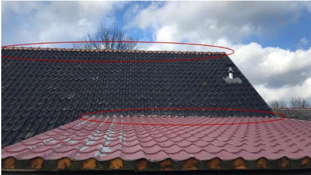
Figuur 2 Potentiele toegang naar achterliggende ruimte zijn ontoegankelijk gemaakt door purschuim.
