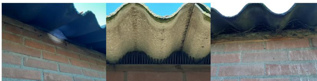
Figuur 4 Getroffen maatregelen tegen vogels in de dakruimte.
