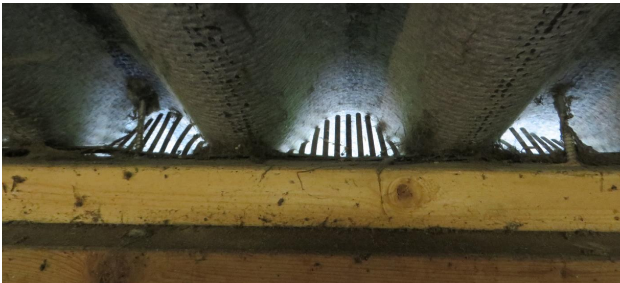
Afbeelding 5.1. Het vogelschroot dat is geplaatst in de te slopen panden. Foto: Natuurkompas, 2019.
