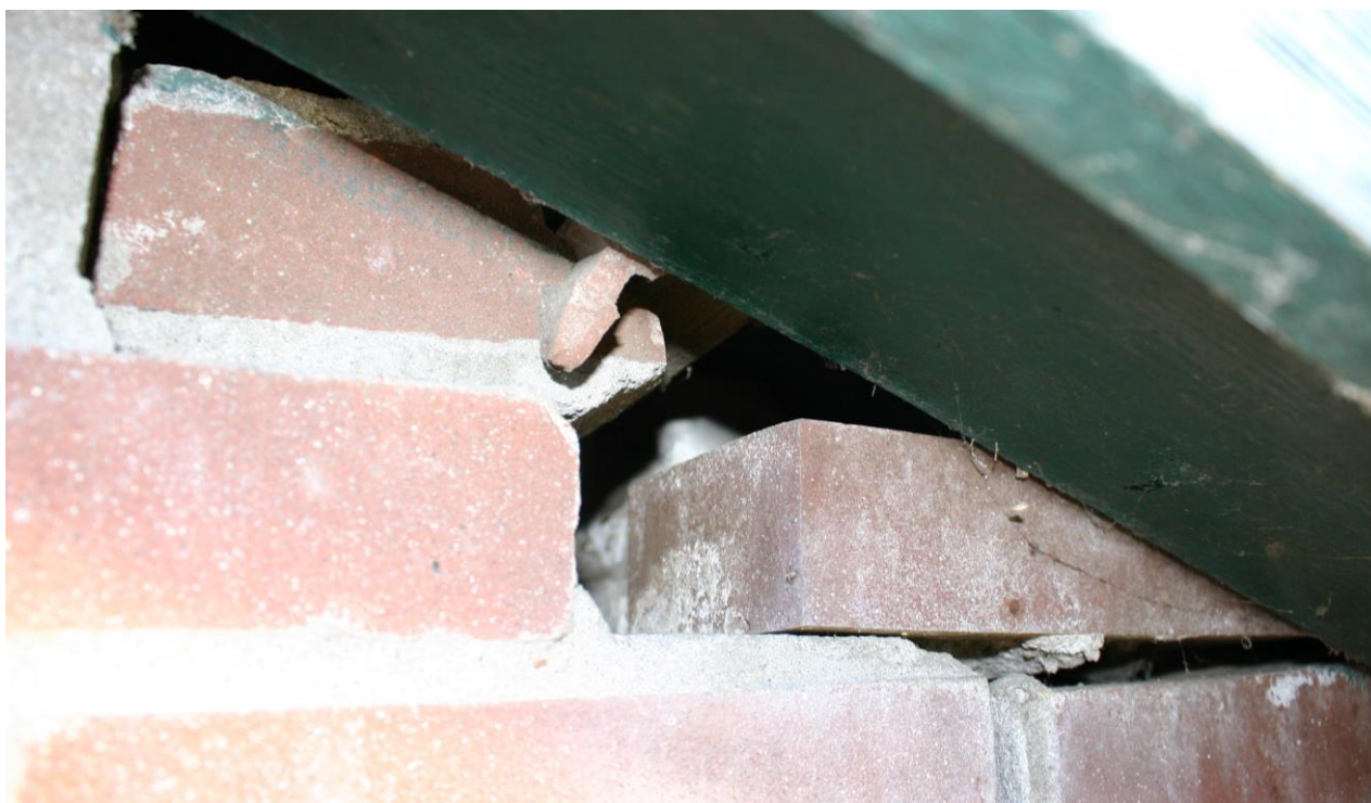
Figuur 4.5.3. In de voorgevel van de paardenstallen is een gat ontstaan.
