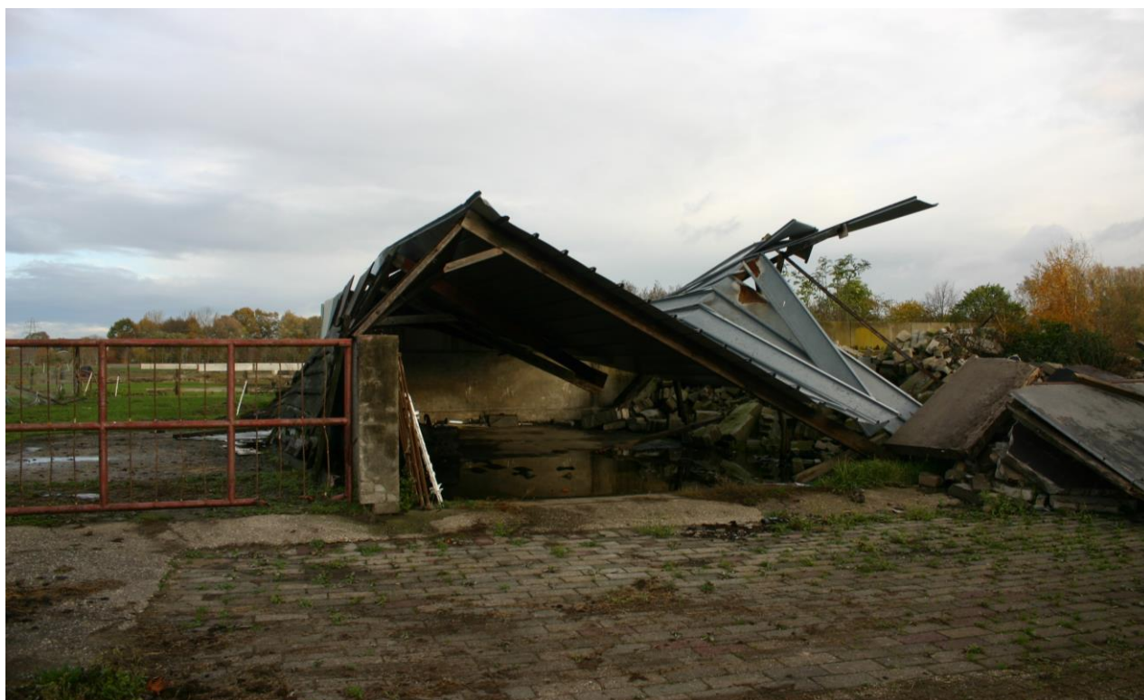
Figuur 4.1.2. De berging in het plangebied is ingestort.
