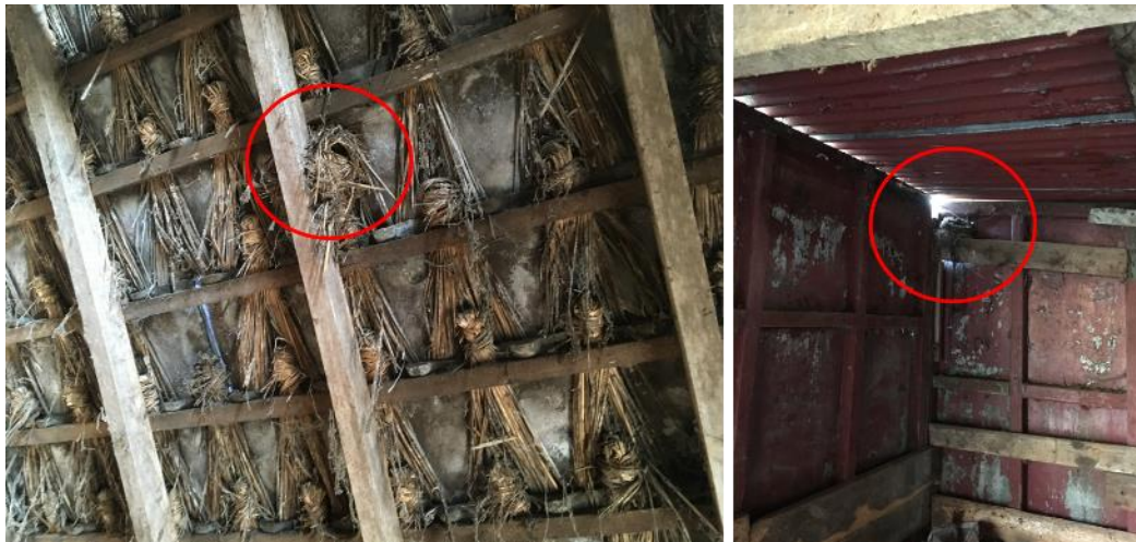
Figuur 3a,b (a) In een van de bijgebouwen is een nest van winterkoning aangetroffen; (b) in een ander gebouw is een nest van een merel aanwezig.
