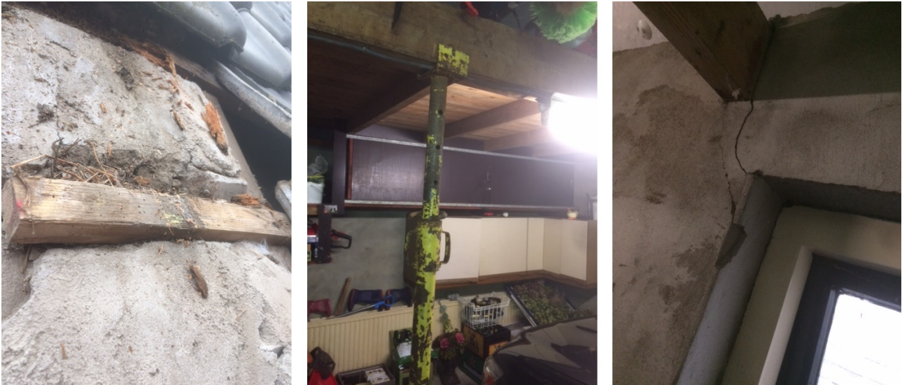
Afbeelding 4: Links: Schade door insecten aan houtconstructie. Midden: Doorhangende balk (draagconstructie) gestut in garage. Rechts: Scheur in dragende wand.
