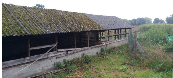
Foto 8: Voormalige stal 6 gezien in noordoostelijke richting met de toegepaste asbesthoudende golfplaten als dakbedekking. Ter plaatse van deze voormalige stal ontbreekt aan beide zijden een dakgoot.
