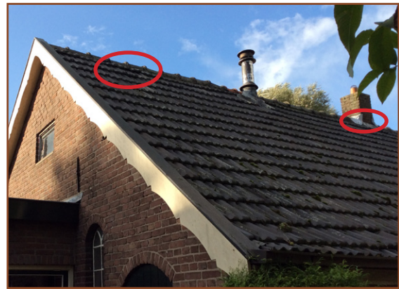
Afb. 2.3: Losliggende dakpannen, afgebrokkeld cement bij de nokpannen en ruimtes bij loodslabben vormen toegangen tot mogelijke vleermuisverblijven.
