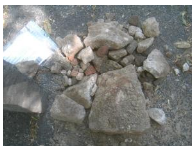
Foto 2: Uitkomend puinhoudend materiaal inspectiegat 2
