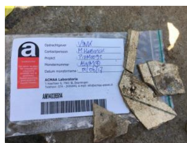
Foto 9: Asbestverdacht plaatmateriaal inspectiegat 4
