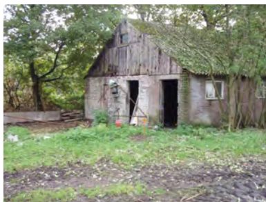
Foto 5: schuur met asbestverdachte dakbedekking
