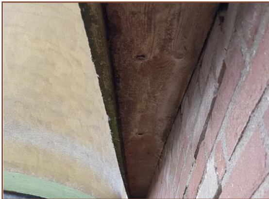
Afb. 2.2 De daklijst van de stal (4) is afgesloten waardoor deze niet geschikt is als verblijfplaats voor vleermuizen en de Huismus.
